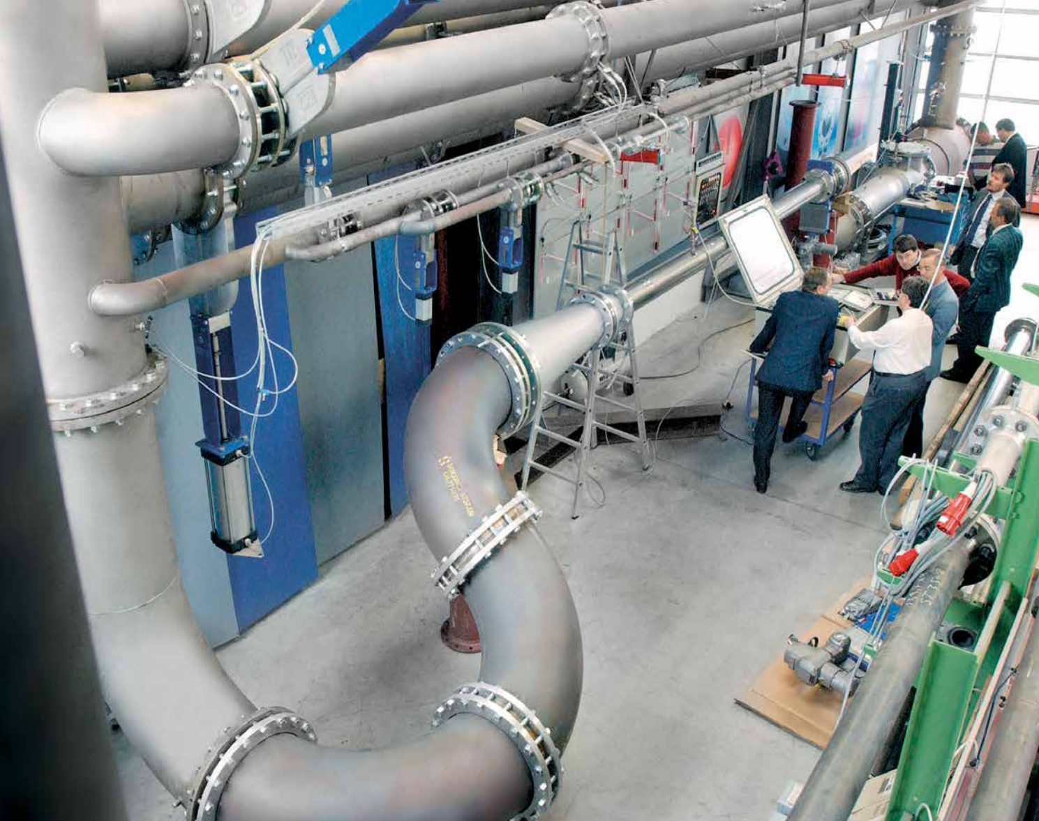
Abnahme der VACOMASS® Lufteintragssysteme für die Hauptkläranlage in Wien in unserem CAMASS® Kalibriertechnikum. Durch eine exakte Simulation der Betriebsbedingungen und der Rohrleitungsführung während der Kalibrierung der VACOMASS® Systeme konnte eine Genauigkeit von 1,5 % für die Messung des Lufteintrages trotz schwieriger Rohrleitungsführung gewährleistet werden.
