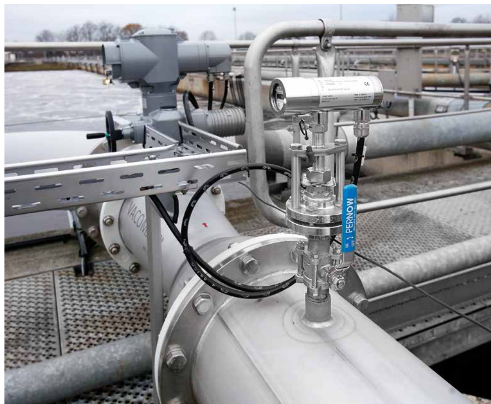
Foto oben: VACOMASS® flow meter SS ist direkt vor dem jet control valve positioniert und mit der verdreh-sicheren Einschleusevorrichtung Typ OEIN-F montiert. Foto rechts oben: VACOMASS® flow meter AL100 mit integrierter automatischer Strömungsprofilkorrektur des Signals durch einen zusätzlichen Analogeingang
